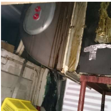
Figura 45 – Inadequadas condições de manutenção de equipamentos apesar de existir equipa de segurança
