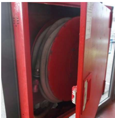
Figura 77 – Rede de Incêndio Armada com sinais de degradação
