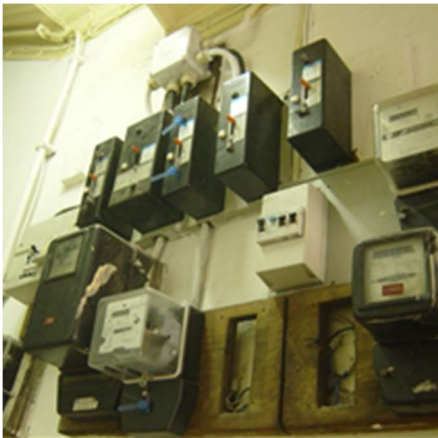
Figura 18 - Quadro de entrada do edifício que não cumpre as regras de segurança, evidenciando intervenções que não respeitam as regras de boa arte
