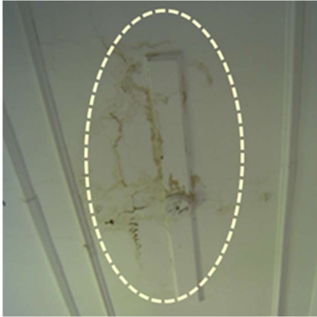
Figura 14 – Humidade próximo de um componente elétrico, o que pode motivar um curto circuito
