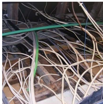
Figura 21 - Execução caótica da instalação, que contraria as regras de boa arte
