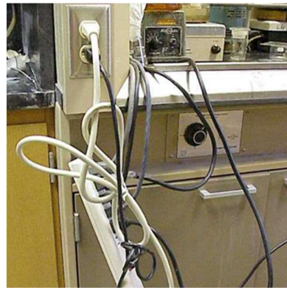
Figura 19 - Ligação de diversos equipamentos a um mesmo circuito, recorrendo a uma instalação improvisada (fichas e tomadas móveis)
