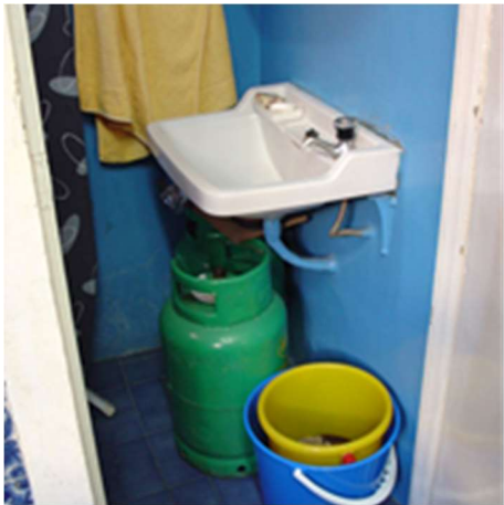
Figura 25 – Instalação de gás em deficientes condições de localização
