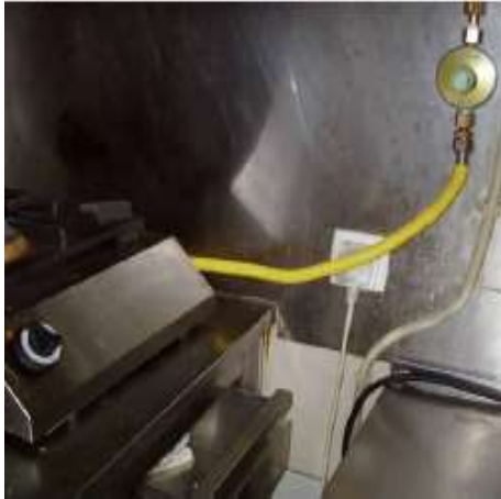
Figura 23 – Instalação de gás em deficientes condições de manutenção e segurança
