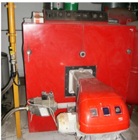
Figura 27 – Caldeira a gás e queimador
