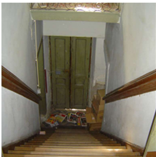
Figura 65 – Escada com inclinação excessiva
