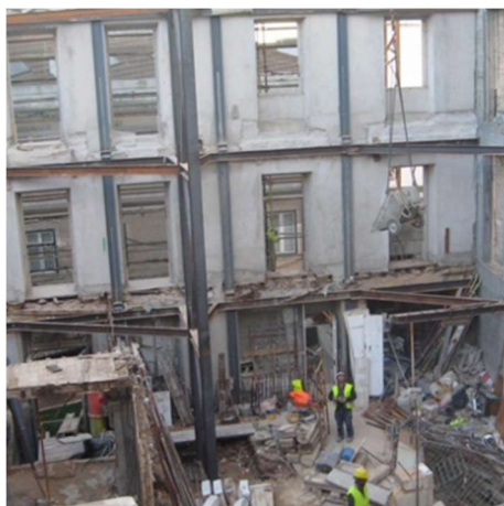
Figura 6 – Reconstrução precedida de demolição integral do edifício pré-existente, com manutenção das paredes exteriores
