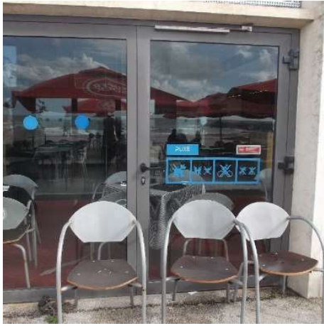
Figura 41 – Obstáculos em frente de saídas de emergência
