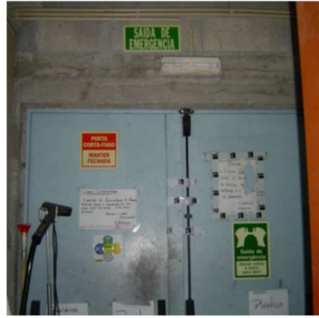
Figura 42 – Porta de caminho de evacuação bloqueada
