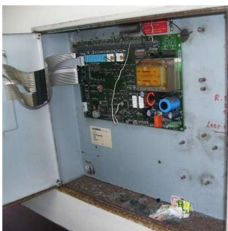
Figura 47 - Central de deteção automática de incêndio evidenciado inadequada manutenção
