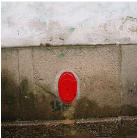
Figura 73 – Boca-de-incêndio em edifício
