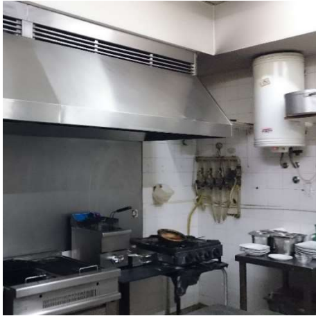
Figura 32 – Pormenor da hote e equipamentos diversos de confeção de alimentos
