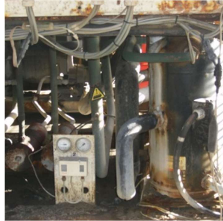
Figura 37 – Refrigerador ( chiller ) de AVAC apresentando alguns sinais de degradação
