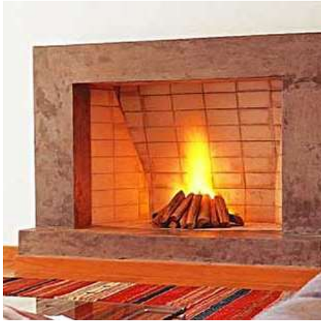
Figura 30 – Aparelho de queima de combustíveis sólidos não regulamentar porque não possui proteção contra a queda e projeção de partículas incandescente
